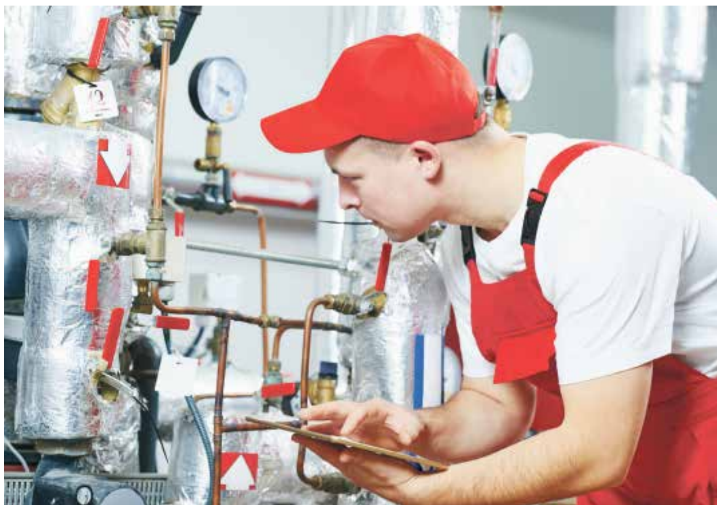
Heizungsanlagen auf dem Prüfstand: Der Wärmesektor spielt eine Schlüsselrolle bei der Erreichung der deutschen Klimaziele.
